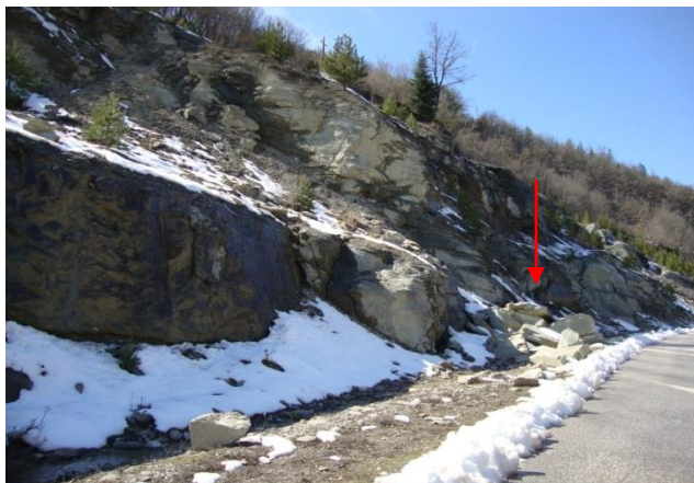
Εικόνα 14: Κατολίσθηση πριν τον οικισμό Πεύκος X= 243264 Y= 4477236
